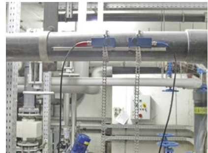
Thermal energy metering at Stadtwerke München
